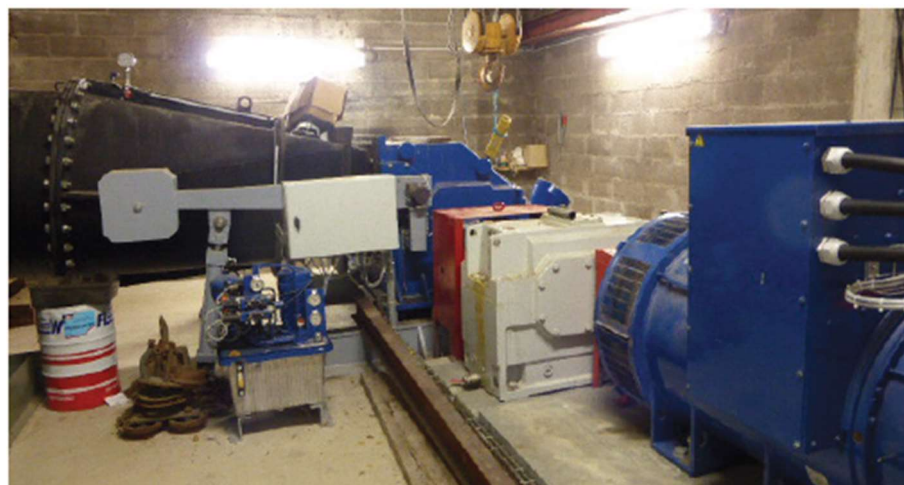
Turbine Crossflow de 400 kW sous 22 m de chute à Château-Chinon (58).
