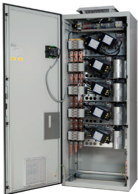
Batteries dynamiques pour un besoin de compensation instantanée
